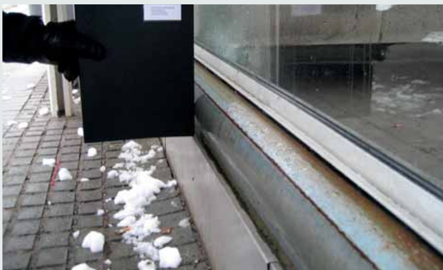
Deformeret firkantprofil på grund af vand i profilet
