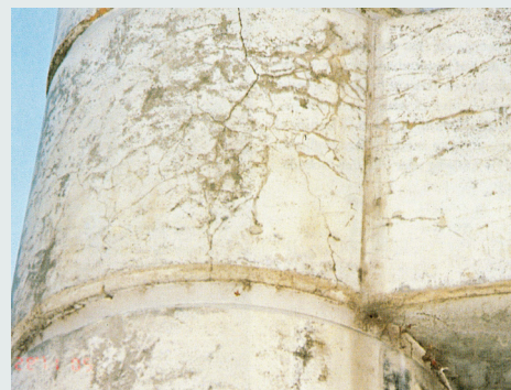
Netrevner i ubeskyttet betonkonstruktion
