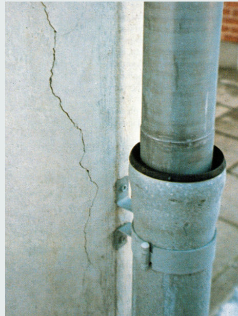
Skader på beton, som er leveret fra en fabrik, som ikke er omfattet af Betonelementkontrollen
