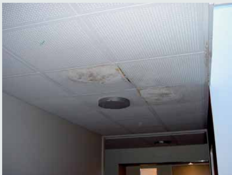
Vandgennemtrængning ved loftplader.
