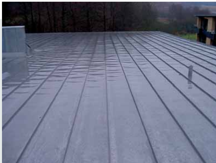
30 meter lange zinkbaner, hvor vand vil kunne stuve op over false ved heftig regn og blæst.
