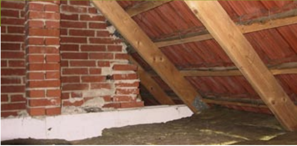
Eksempel på mangel: Brandmæssig tætning ved lejlig- hedsskel i tagrum mangler.
