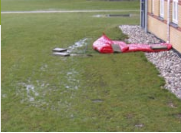
Eksempel på mangel: Stående vand på terrænet.
