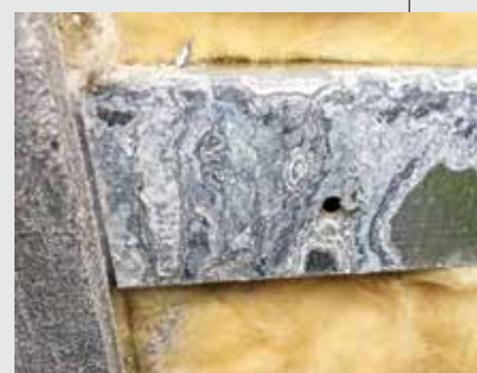
Stålskelet med korrosion og stålprofil angrebet af hvidrust.
