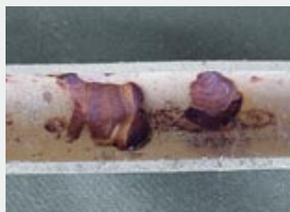
Undgå korrosionsskader i brugsvandsanlæg
