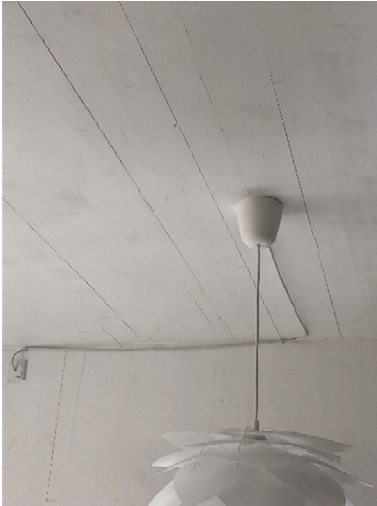
CLT-elementer anvendes også som dæk. Her ses svindrevner i loftet.
