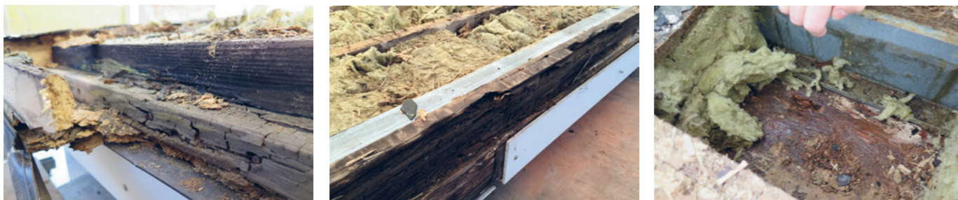
Rådskade i tagkassettes konstruktionstræ med påhæftet sternplade. En tilsvarende plade endte i gården, fordi skrueerne havde løsnet sig i det rådne træ.
