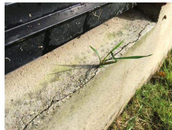
Eksempel på revnet sokkelpuds. Fra BYG-ERFA blad (12) 18 12 09 - Revner i sokkelpuds på letklinkerblokke.
