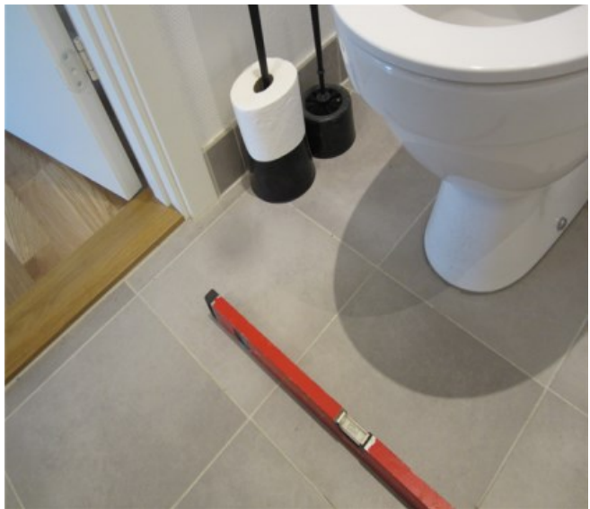
Driftseksempel: VANDRET GULV ved dør betyder øget drift, og der skal monteres et metalprofil på dørtrinnet for at beskytte trætrinnet.
