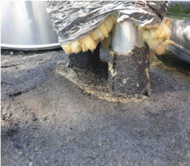
Driftseksempel: GENNEMFØRING uden brug af krave eller lignende er en uortodoks løsning, der kræver øget kontrol.
