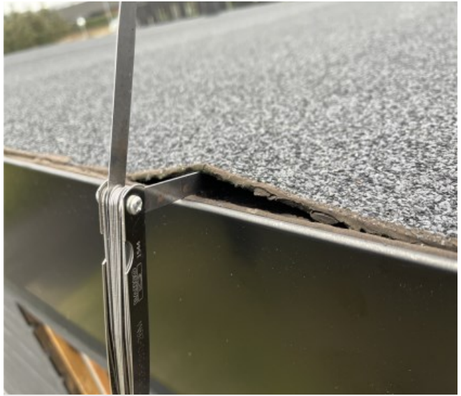
Driftseksempel: Løst TAGPAP på tag med lav hældning skal udbedres.
