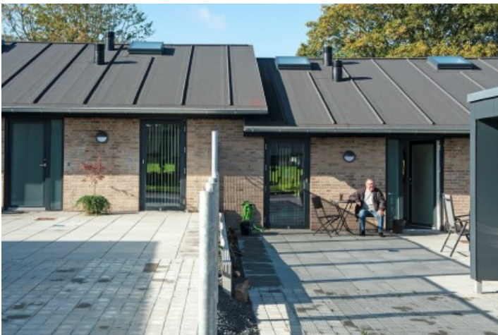
Svært tilgængelige samlinger. Sandsynlighed for krævende drift. Th. Brorsonsvej, Nordborg, Boligselskabet DANBO, Mangor & Nagel Arkitekter.
