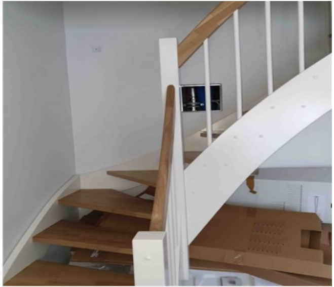
Driftseksempel: INSPEKTIONSLEMMEN er kun 30 x 30 cm, og for lille til at kunne inspicere eller udskifte installationer gennem lemmen.
