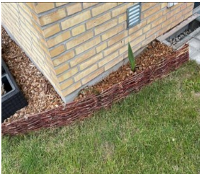
Driftseksempel: SOKKELHØJDEN er utilstrækkelig, og facadebeklædningen kræver derfor øget drift.
