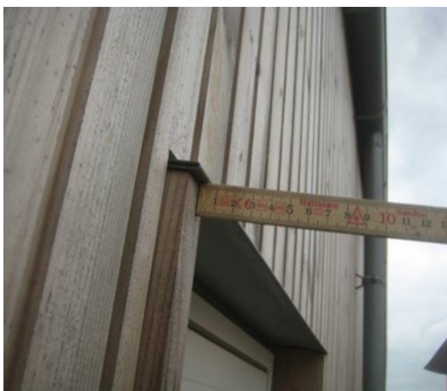
Driftseksempel: VANDNÆSE over vindue rager mindre end 30 mm ud over træstolpe. Stolpens levetid bliver kortere.
