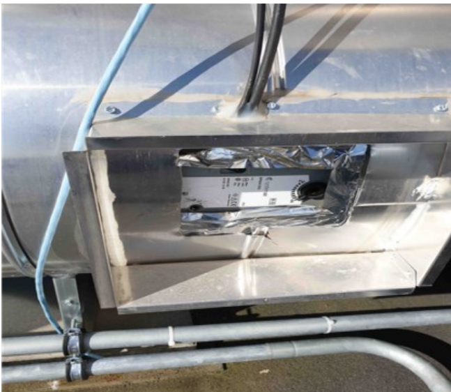
Driftseksempel: KABELGENNEMFØRINGEN i toppen af ventilationsaggregat på taget er tætnet med silicone og skal efterses ofte for at undgå vandindtrængning.
