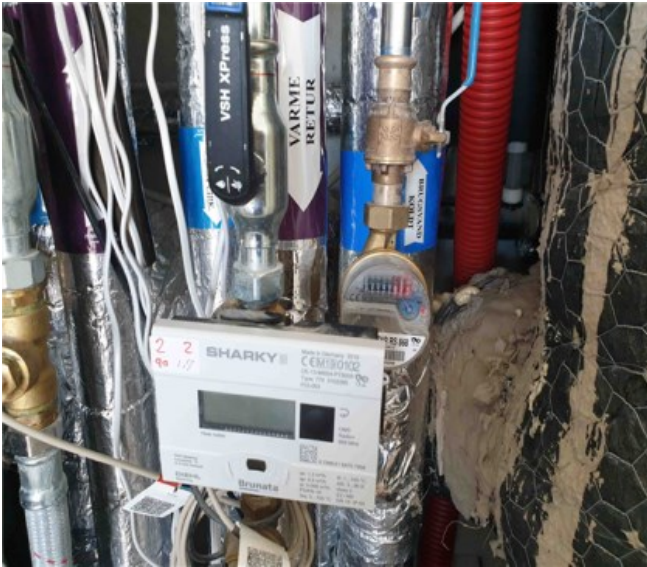
Driftseksempel: FORDELERRØR til vand kan ikke inspiceres eller udskiftes uden, at andre installationer skal afmonteres.
