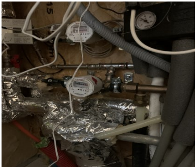
Driftseksempel: MESSINGFITTING OG RØR af rustfrit stål er en dårlig kombination, der kan føre til interkrystallinsk korrosion og pludselige brud med voldsomme vandskader til følge.
