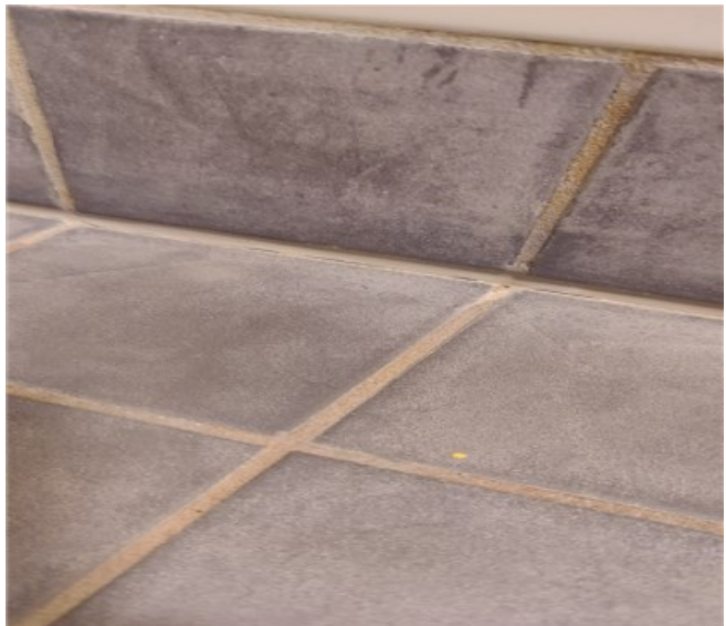
Driftseksempel: Fugeslip i SOKKELKLINKE skal udbedres for at sikre tæthed.
