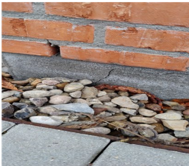
Driftseksempel: SOKKELPUDSEN er revnet og skaller af.
