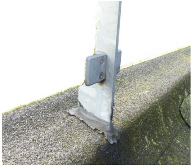
Driftseksempel: Driftskrævende – eller skadevoldende – forsøg på at fuge sig til tæthed ved GENNEMFØRING af balustre i tagterrasse.
