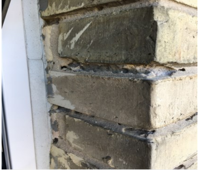
Driftseksempel: MURVÆRK i ringe forfatning. Mørtlen er porøs og blæser ud med vinden. Der kan trænge vand ind, hvis det ikke udbedres og vedligeholdes.
