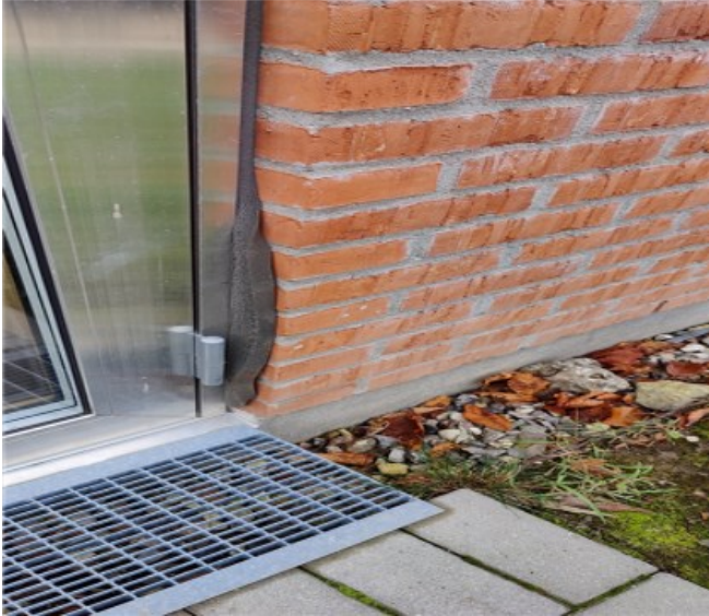
Driftseksempel: FUGEBÅND ved dør er faldet ud.
