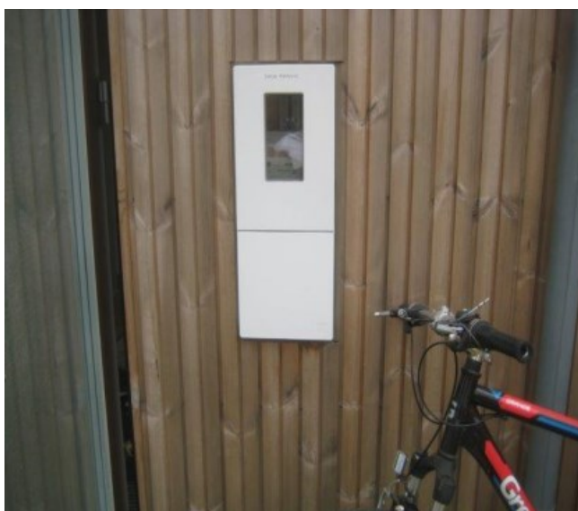
Driftseksempel: Elmåler er indsat i træfacade uden VANDNÆSE eller SÅLBÆNK til at beskytte træværket.
