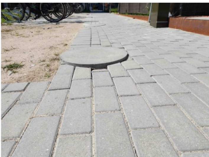
Driftseksempel: DÆKSLET er for højt, og det ujævne terræn kan resultere i snubleulykker og besværliggøre snerydning.
